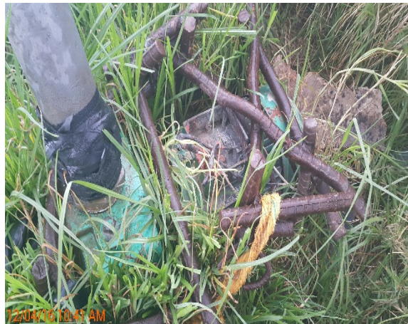
Fotografía 3. Situación encontrada en el operativo realizado el 12/04/2016, donde se evidencia violación de sellos y sistema de captación activo.
